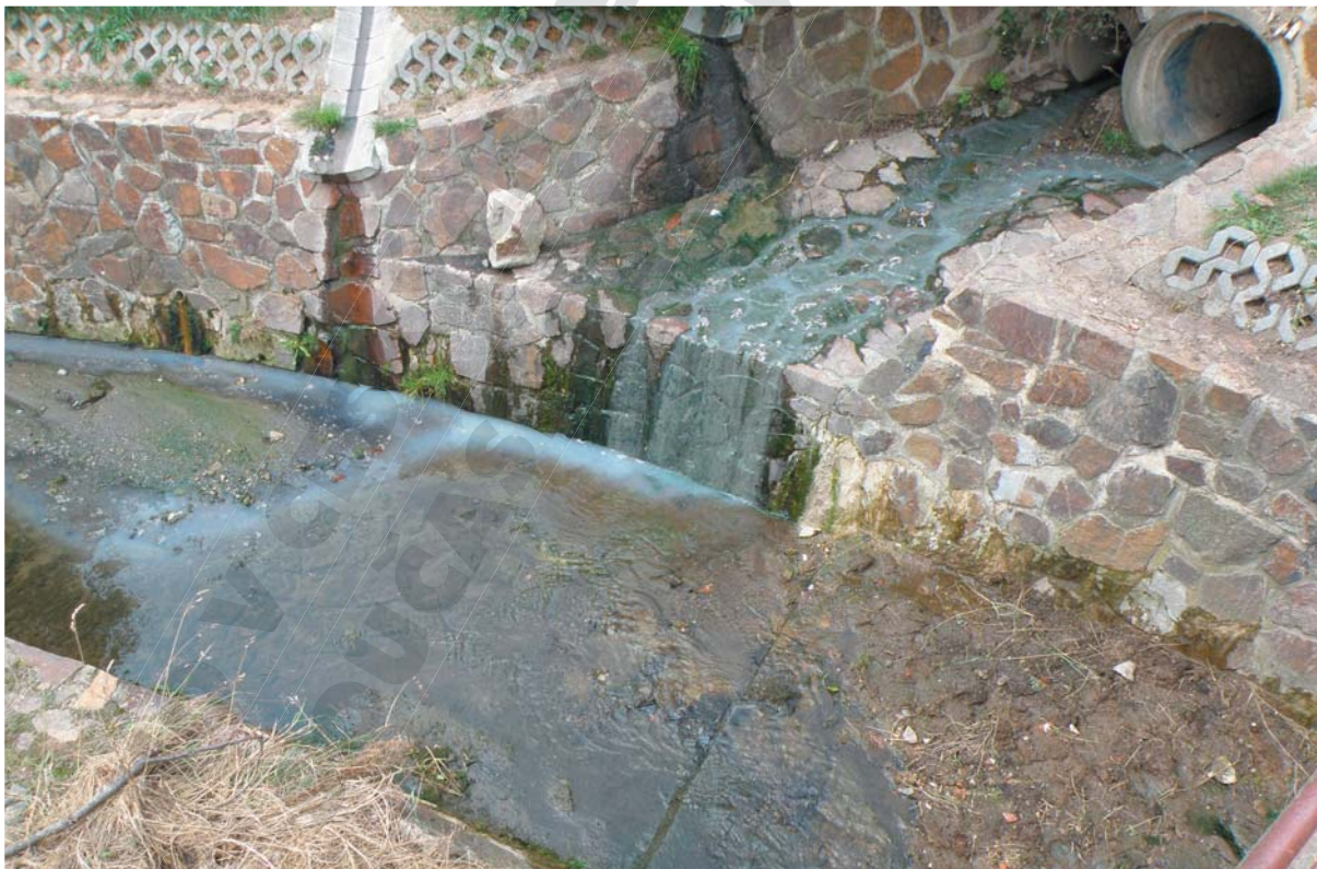
Obr. 220. Příklad znečištění vody dne 27. srpna 2009 v Rakovníku (Rakovnický potok) (foto Archiv Výzkumného ústavu vodohospodářského T. G. Masaryka) Figure 220. Example of polluted water inflow, 27 August 2009, Rakovník (Rakovnický potok Brook) (photo Archives T. G. Masaryk Water Research Institute)
